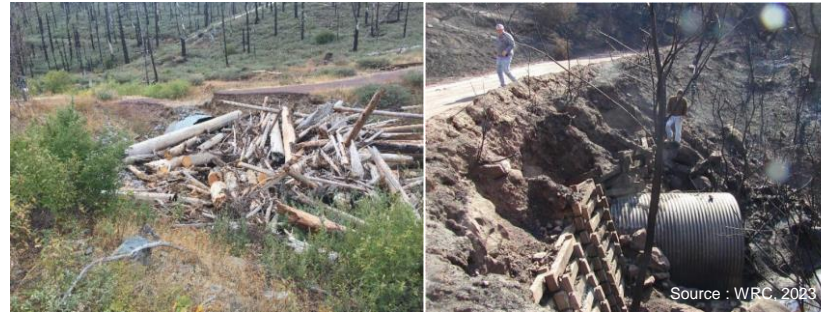
Buse endommagée par une inondation suivie de feux de forêt, Californie
